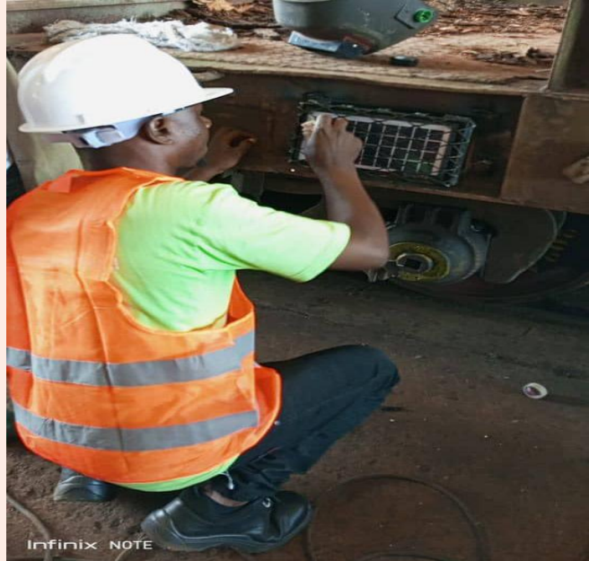
Installation de balises GPS sur les wagons chez CAMRAIL, système alimenté par panneau solaire
